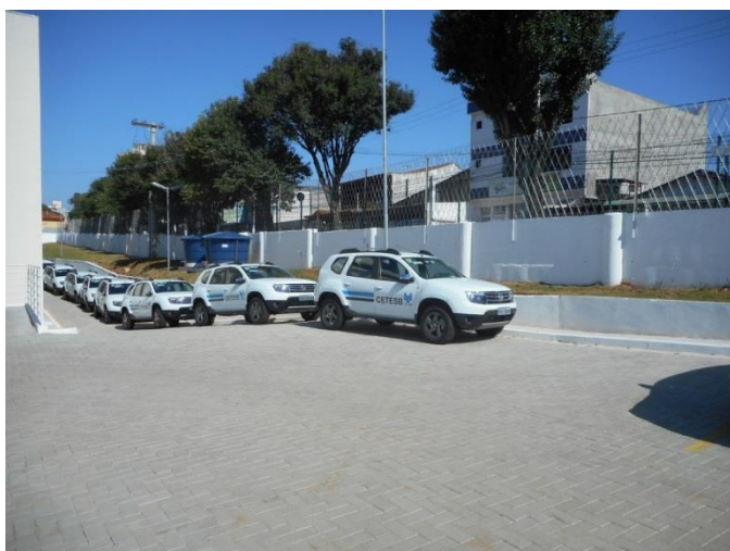
Instalação de concertina e rede laminada ao redor de todo o complexo
