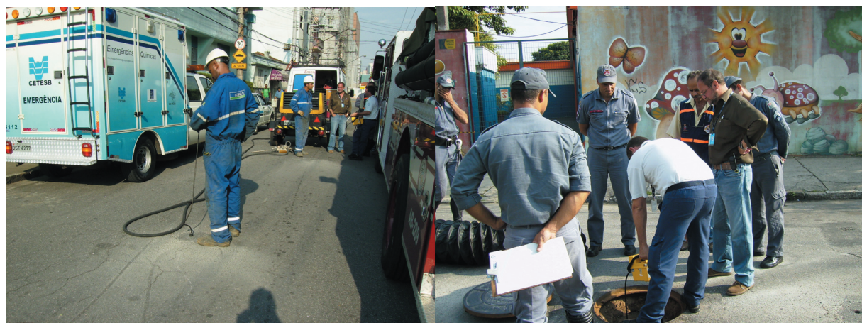
Figuras 4.20 e 4.21: Equipes realizando atendimento a odor de gás em rede de esgotos na Rua dos Cristais.
