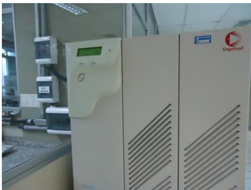
Foto 3. Rede elétrica modernizada e nobreak do LC-MS/MS
