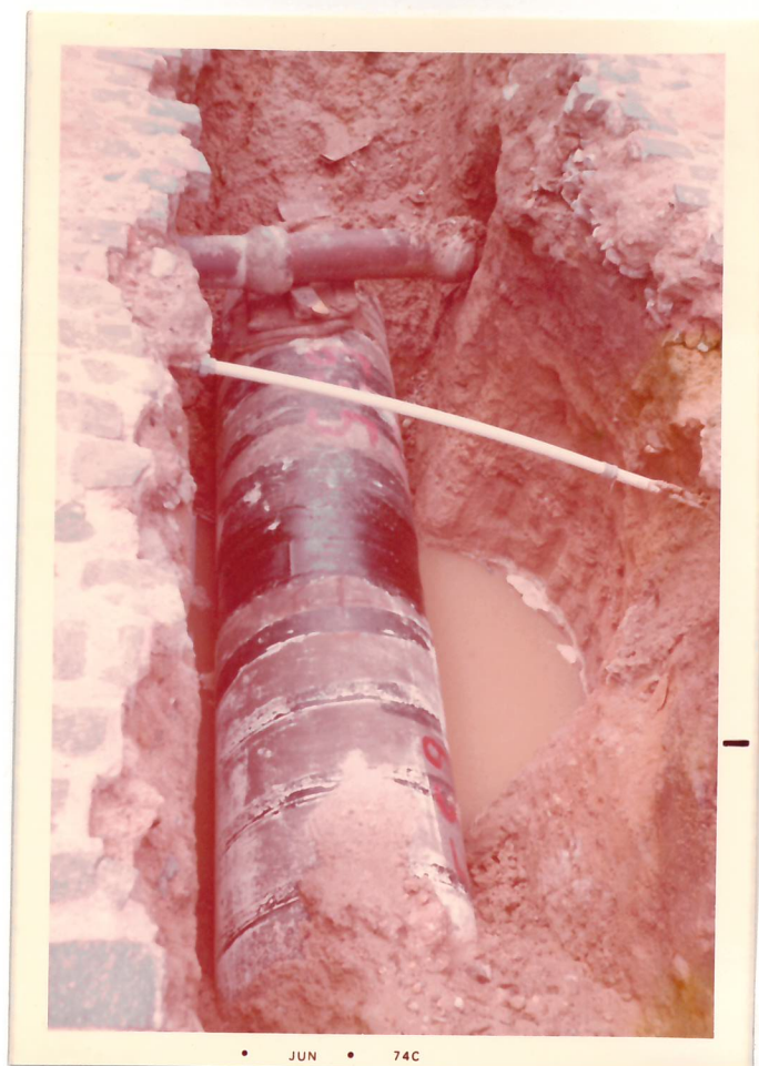
46 - Tubo da rede de esgotos apoiado sobre a tubulação, com berço improvisado.
