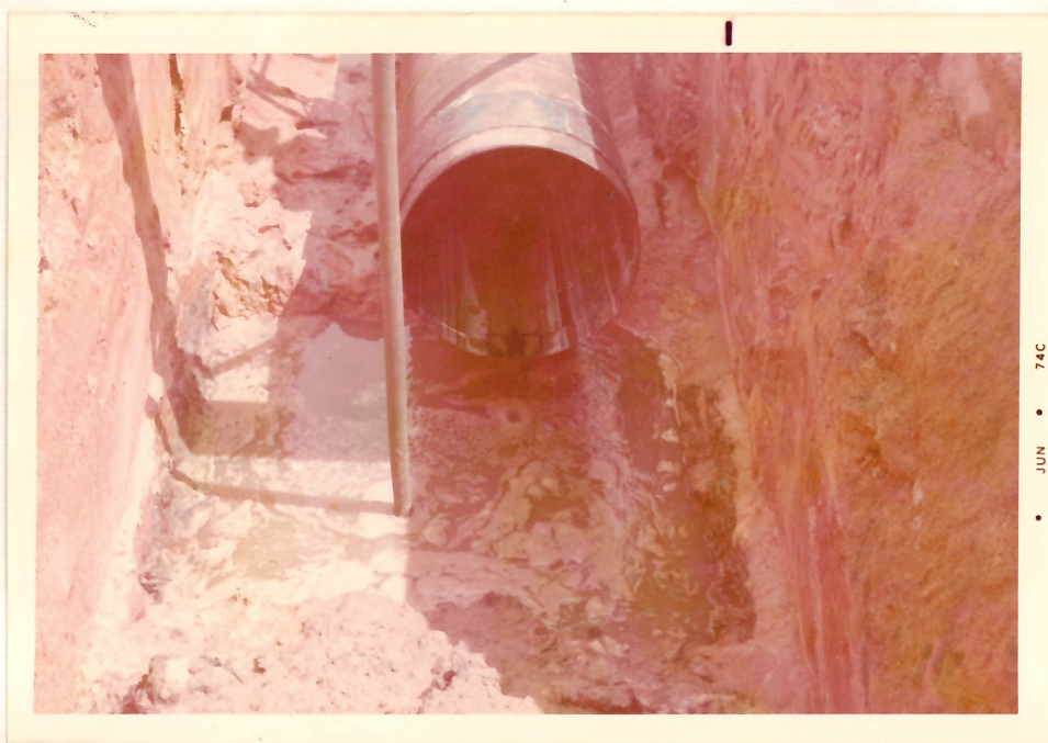
25 - Esgotamento do cachimbo com balde, apesar da existencia de bombas de boa qualidade.
