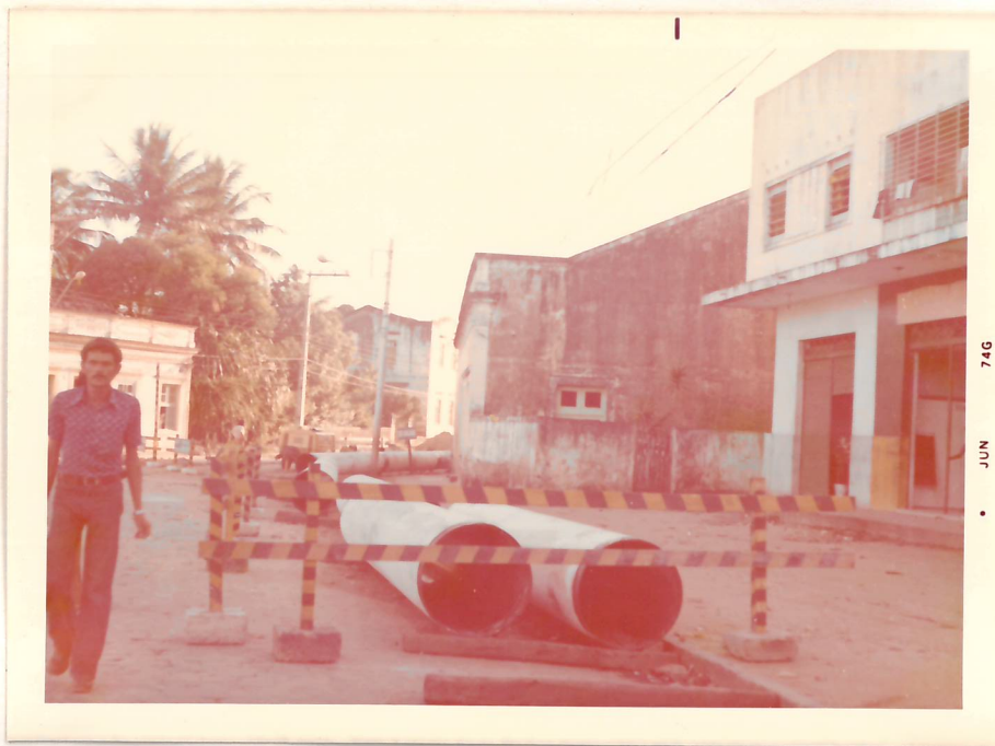
30 - Flagrantes de uma correta colocação dos tubos na beira da vala. Notar a sinalização e os berços apesar de irregulares, bem colocados.
