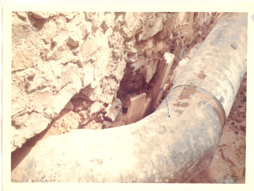
9 - Tubulação exposta à espera de solução. Note-se o detalhe da madeira servindo de apoio.
