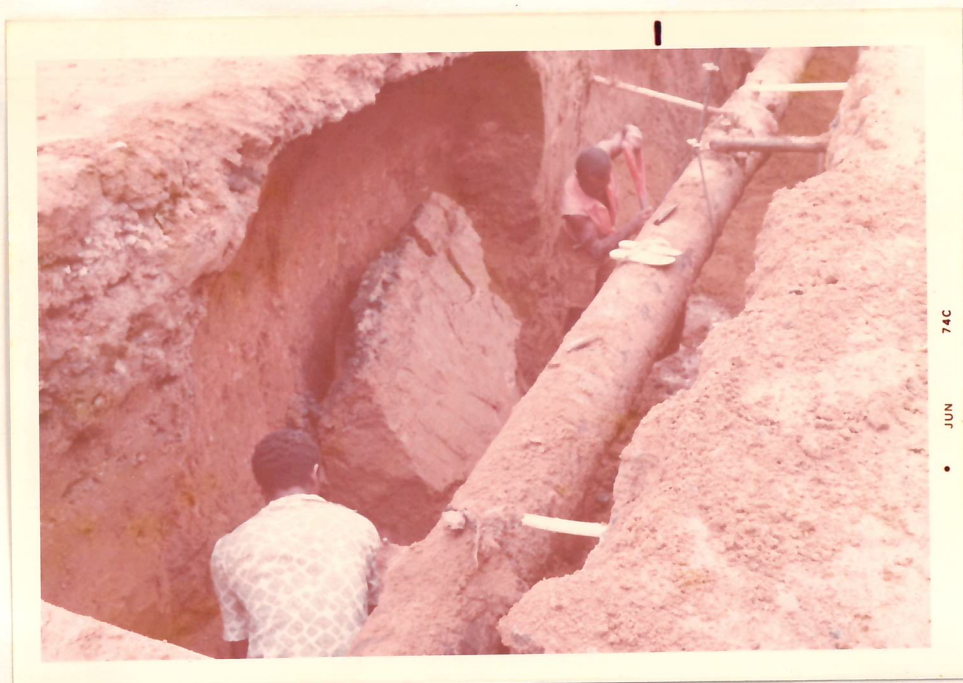
26 - Desmoronamento da vala.
