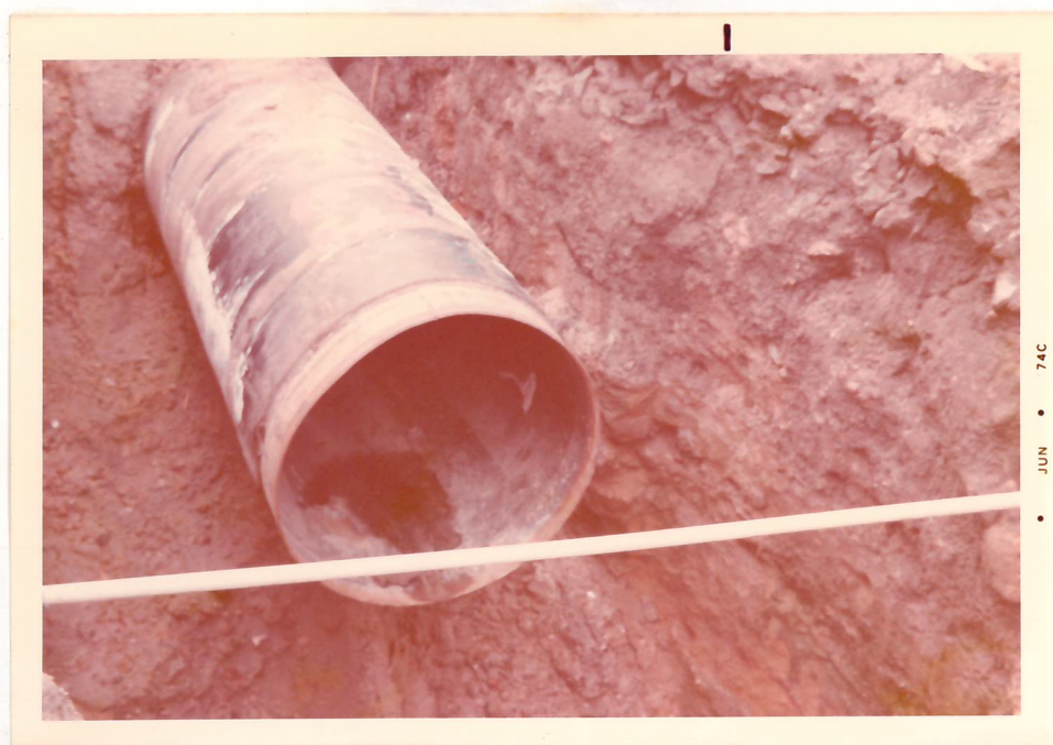
37 - Tubo amassado, por falta de cuidado no manuseio.
