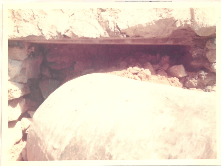
3 - Pedras sobre a tubulação.
