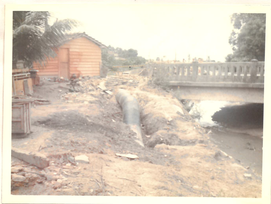
12 - Tubulação exposta a espera de aterramento, apesar de liberada pela inspeção.
