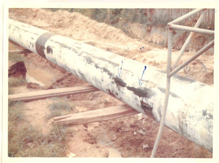
5 - Detalhe do tubo com grande número de reparos.
