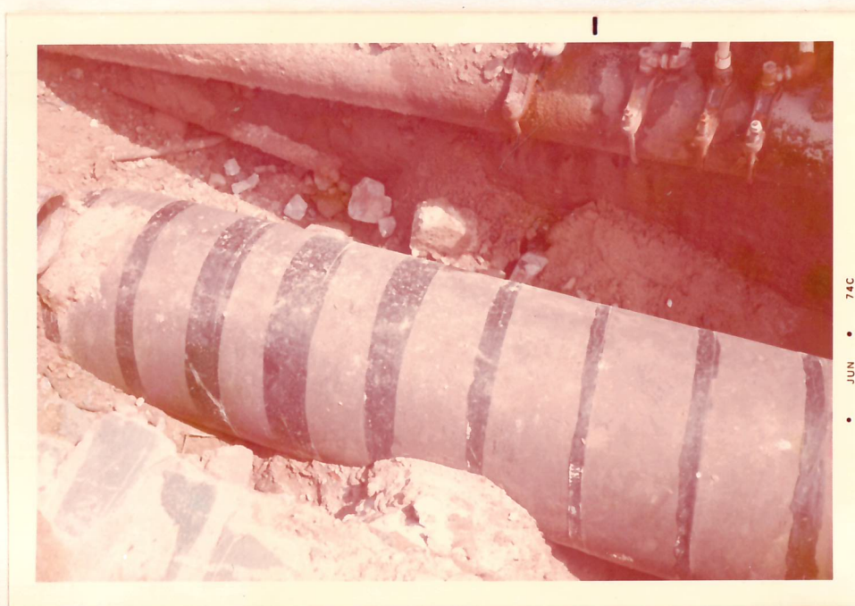
22 - Pedras carreadas pela chuva, em contato direto com o revestimento.
