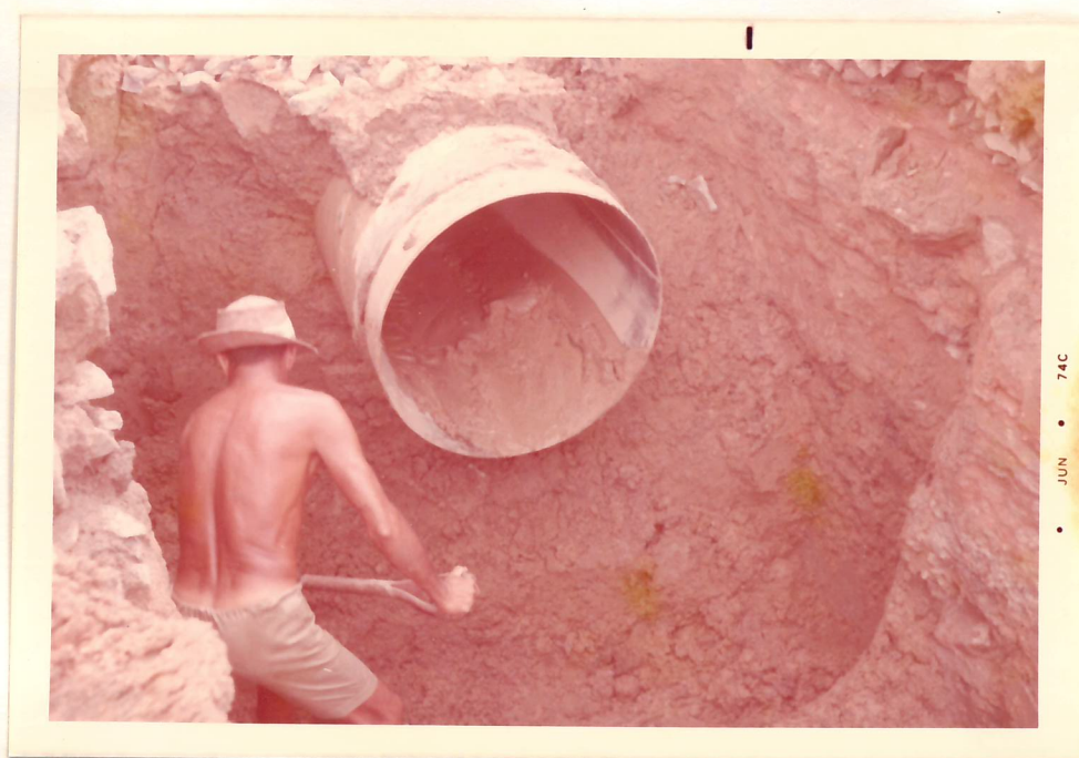
23 - Tubulação cheia de lama e cachimbo assoreado pelas chuvas.
