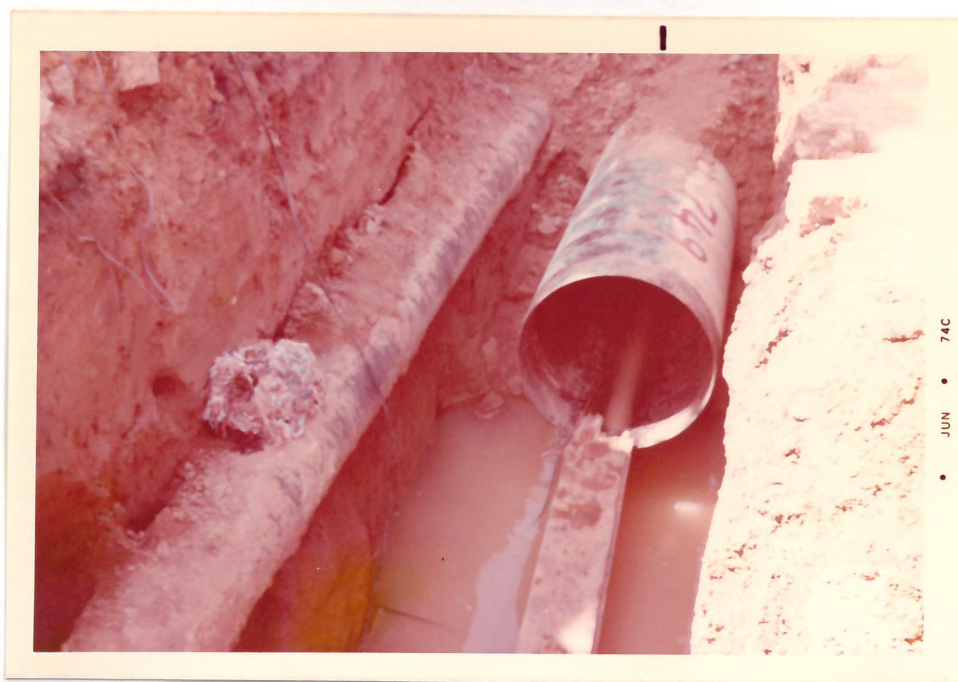
49 - Tubo e cachimbo inundados por alagamento da da vala provocado pelas chuvas.
