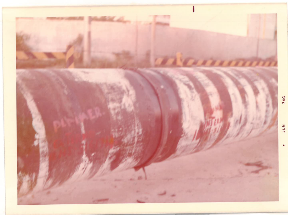
40 - Fotografia mostrando a tubulação de \varnothing 800mm, sendo ensaiada com gamagrafia pelo IEA,
