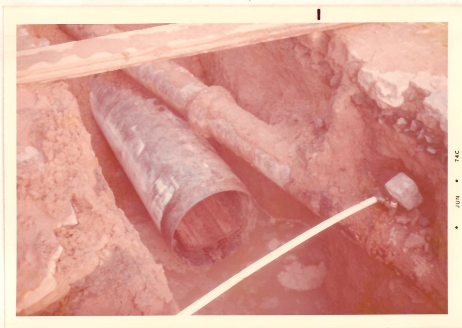
17 - Tubulação de FoFo \varnothing 8" sem escoramento com o risco de cair sobre a tubulação de aço.
