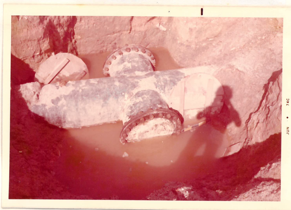
19 - Flanges a espera de aterramento com os pa rafusos sem nenhuma proteção contra oxida ção.
