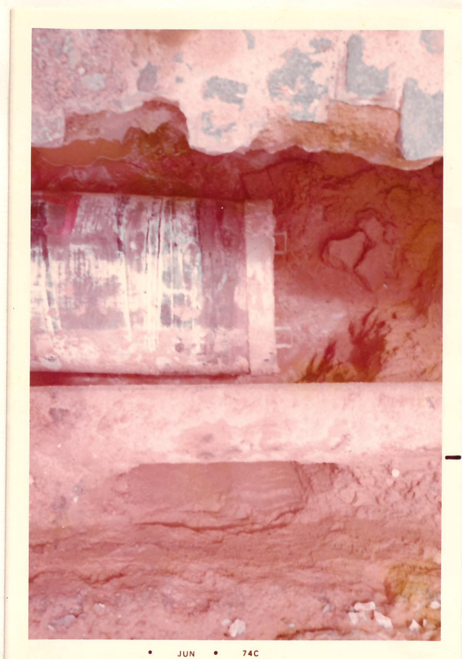
6 - Tampa mal colocada, e desmoronamento na vala.
