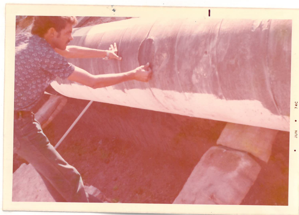
41 - Revestimento avariado por falta de cuidado no manuseio.
