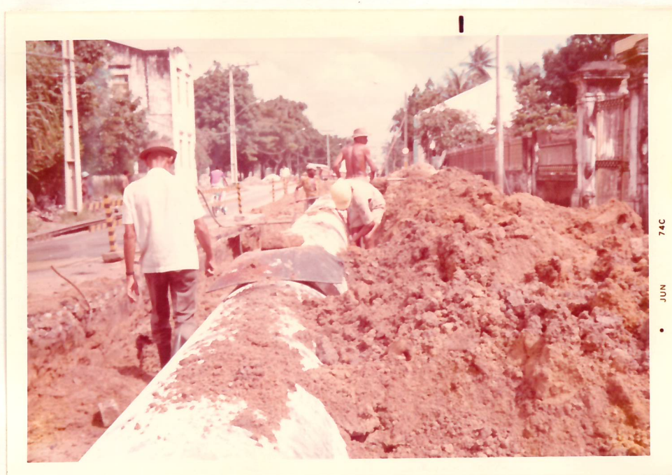
18 - Falta de cuidados com a tubulação. Note-se a terra e o carrinho de mão em contato direto com o chicote.
