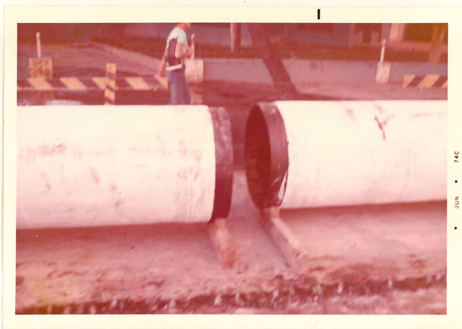
15 - Tubulação com os berços de excelente qualidade.
