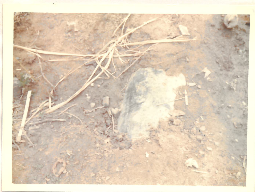
10 - Afloramento do tubo por deficiência no reatêrro, aguardando solução.
