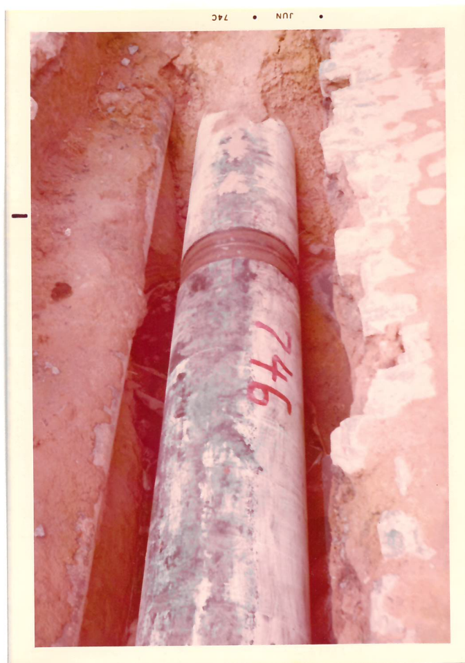
38 - Junta dentro da vala, liberada para re- vestimento, aguardando providências.
