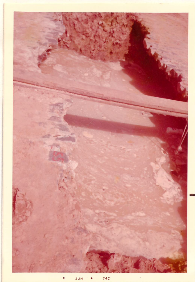
24 - Cachimbo inundado sem bomba para esgotamento, com revestimento a ser feito.
