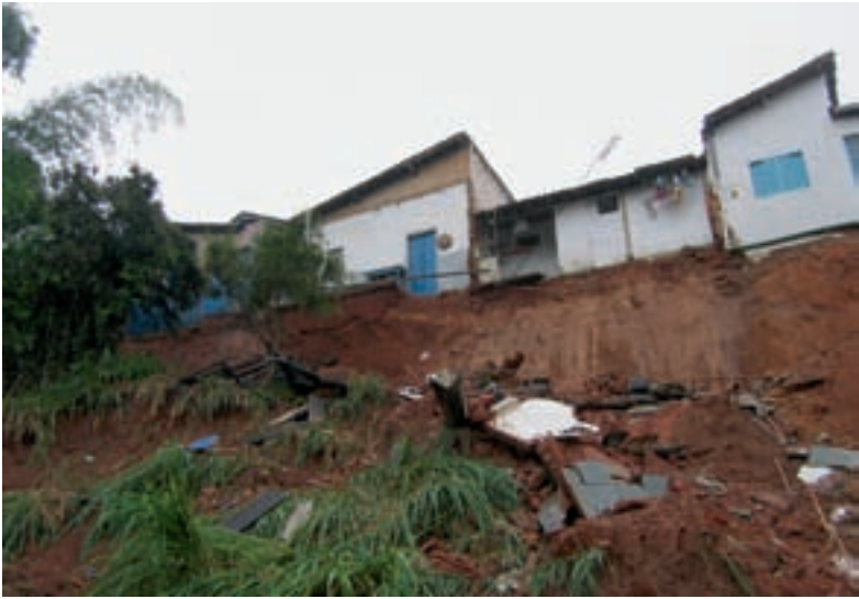
FIGURA 2 – OCUPAÇÃO EM ÁREA DE RISCO.
