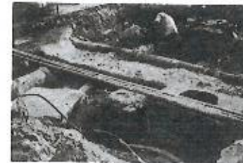
Fig. 3.3 — Obstáculos encontrados numa escavação.
