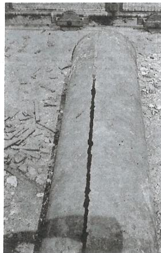
Fig. 4.63 — Abertura da geratriz inferior, por abrasão.
