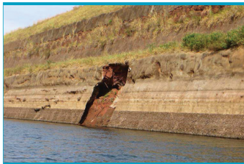
Figura 2.42 - Erosão na lateral do Canal Pereira Barreto.
