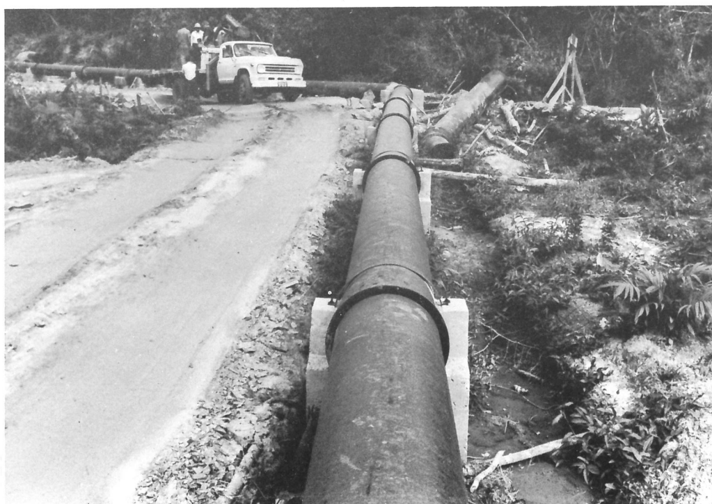
A adutora para Praia Grande, recentemente concluída pela SBS, é uma importante obra que permite fornecer com segurança, água em abundância para uma faixa habitada de 22 km ao longo dessa praia.
