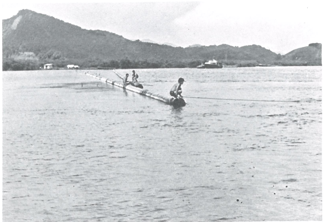
A adutora do Jurubatuba teve que vencer trechos de difícil acesso e trabalho, inclusive rio e braço de mar. No lançamento submarino da tubulação foram utilizadas técnicas e equipamentos especializados.
