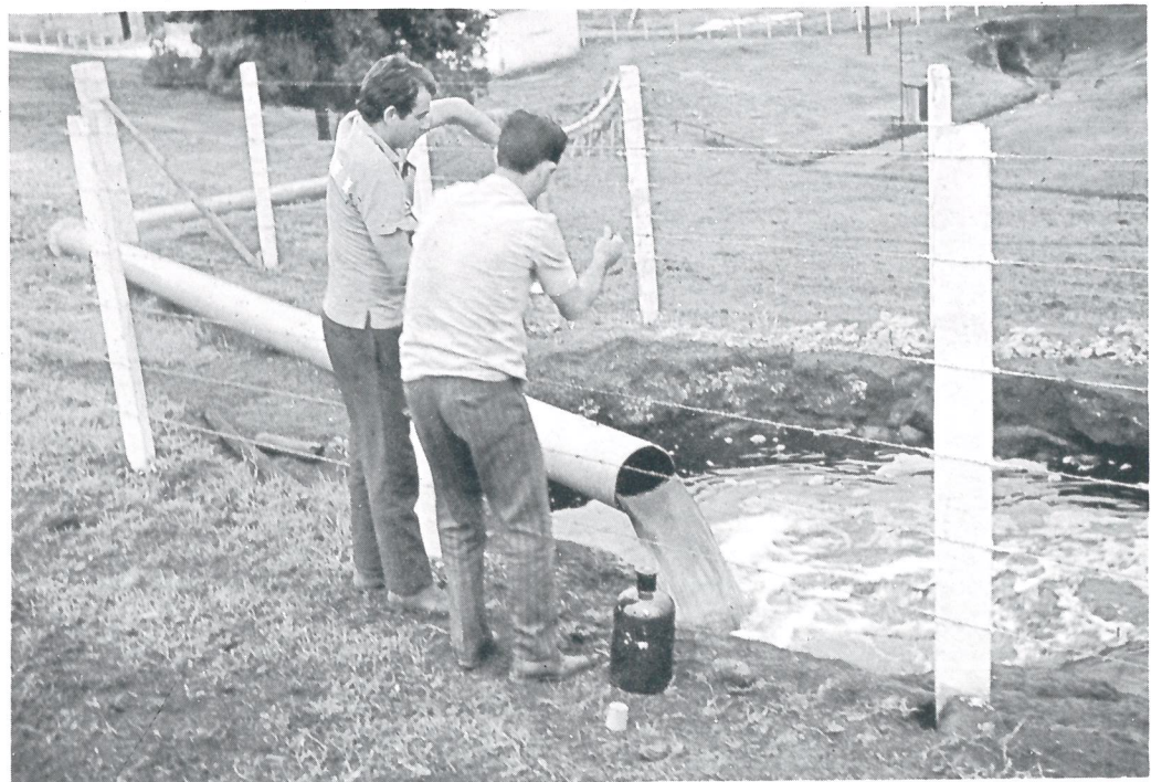
Instalação recém-construída de bombeamento de líquido da coluna barométrica para ser irrigado em valas de infiltração.
