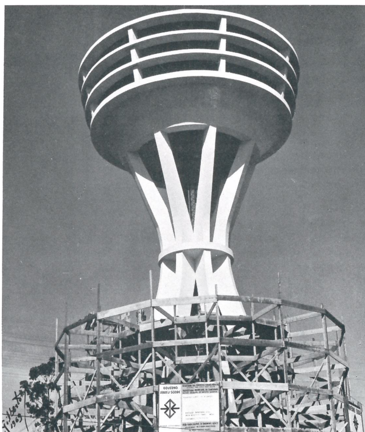
Reservatório elevado típico das obras de ampliação do sistema de abastecimento de Campinas, construído com a fiscalização do FESB, utilizando financiamento da Caixa Econômica Estadual de São Paulo.
