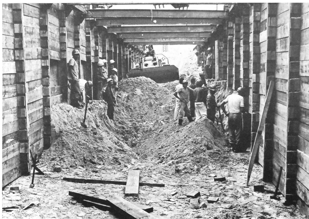
Detalhe da construção do 1.º trecho do Interceptor Oceânico, cuja seção de escoamento será de 2,70 m x 3,00 m.
