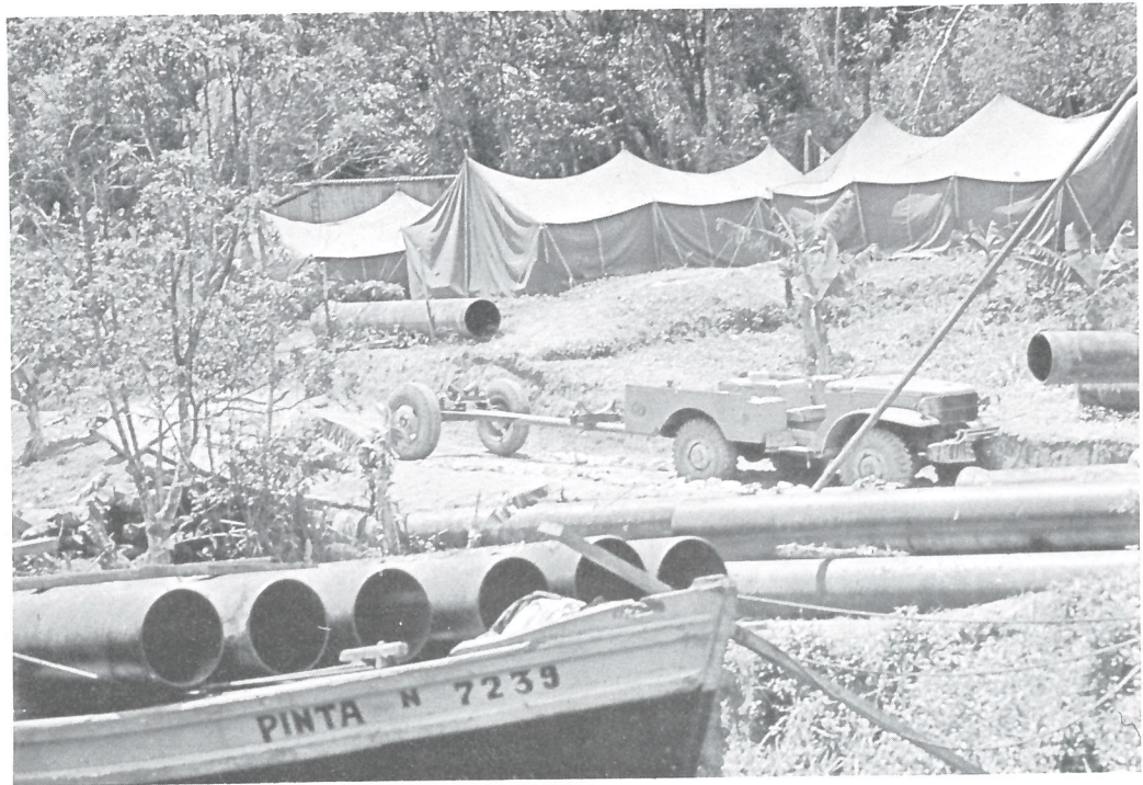
A construção da nova adutora do Jurubatuba, para o reforço do abastecimento de Guarujá e Vicente de Carvalho, assemelhou-se a uma operação de guerra, pela necessidade de utilização de recursos especiais. Com o funcionamento pleno dessa adutora poderá ser atendida uma população de 240.000 habitantes, 4 vezes maior que a servida atualmente.
