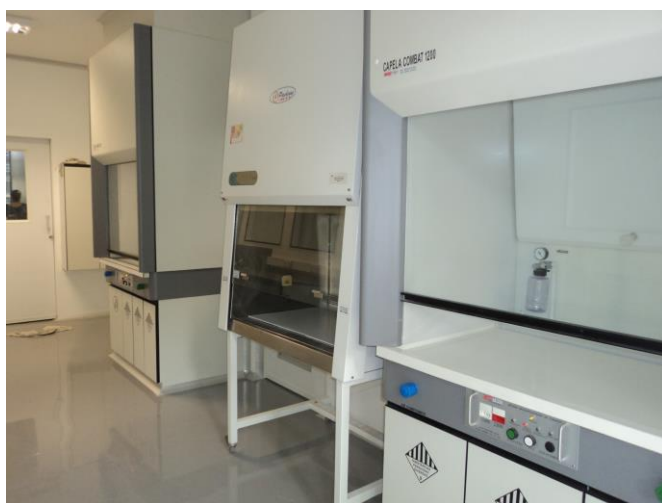
Figura 34. Sala de Preparo - capelas químicas, fluxo laminar e solventes. Fonte: Setor de Engenharia, CETESB
