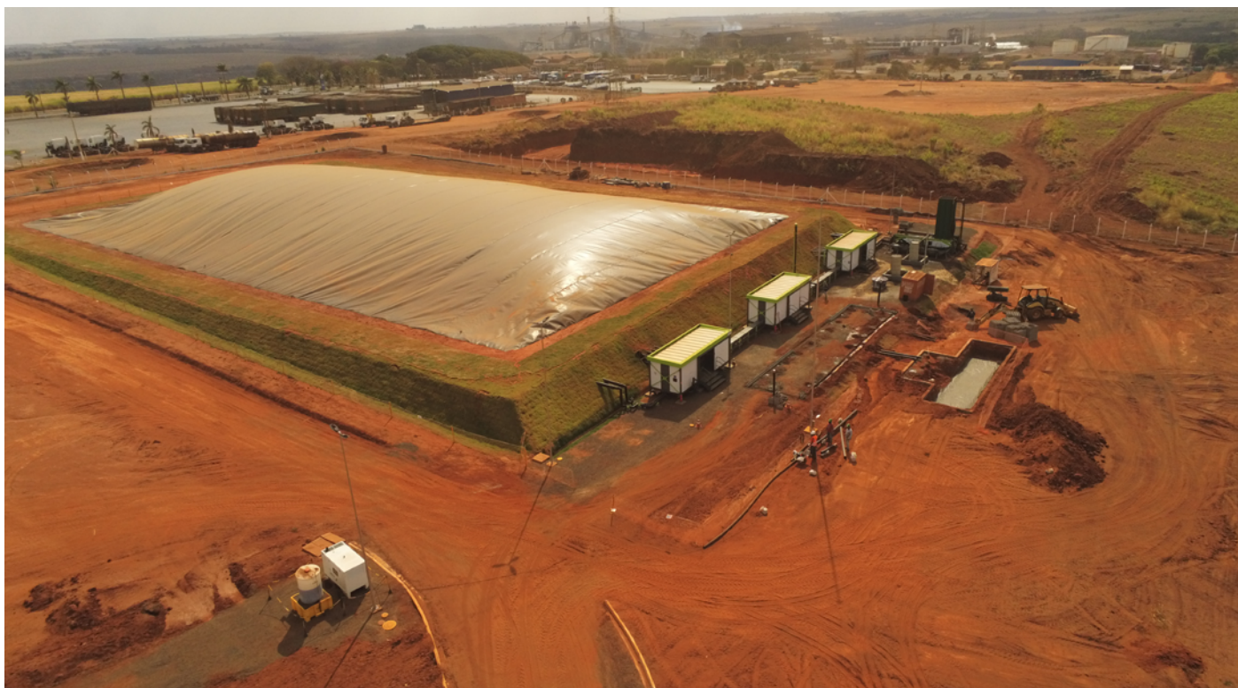
Biodigestor de Vinhaça.
