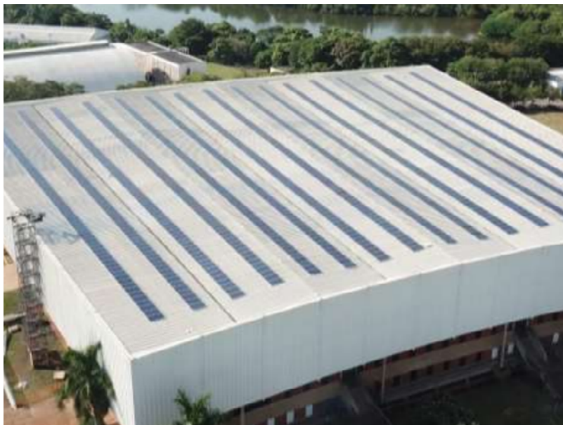
Sistema Fotovoltaico do Ginásio da UNICAMP.
