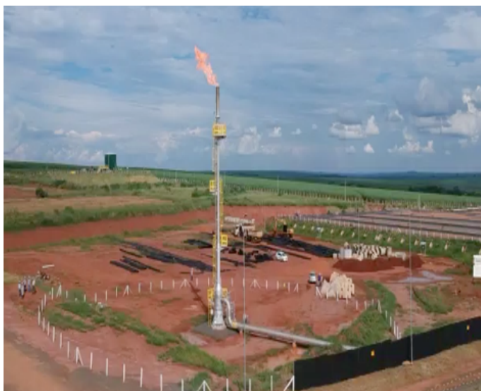
Sistema de flaring da planta.
