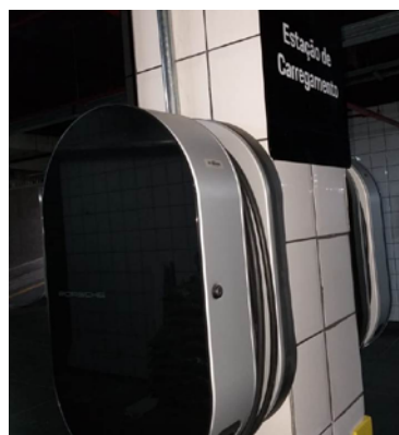
Estação de carregamento.
