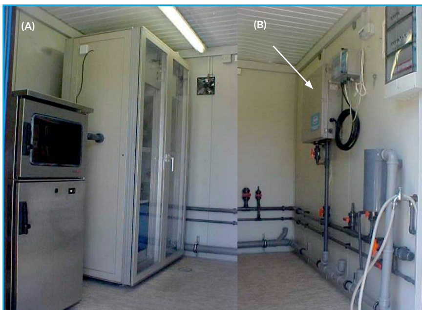
Figura 89. Vista interna do container de uma Estação Automática de Monitoramento: (A) Em primeiro plano o amostrador automático refrigerado e, ao fundo, o gabinete onde estão instalados o CLP e os medidores de pH, OD, temperatura e condutividade elétrica; (B) Turbidímetro (Foto: Luis Altivo Carvalho Alvim/CETESB).
