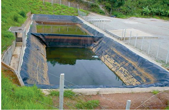
FIGURA 14 – TANQUE DE ACUMULAÇÃO DE CHORUME EM ATERRO SANITÁRIO. Fonte: WOLMER / CETESB, 2008.
