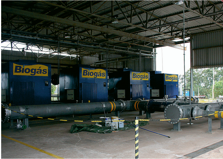
FIGURA 19 - SISTEMA DE RECUPERAÇÃO ENERGÉTICA DE GÁS DE ATERRAMENTO
