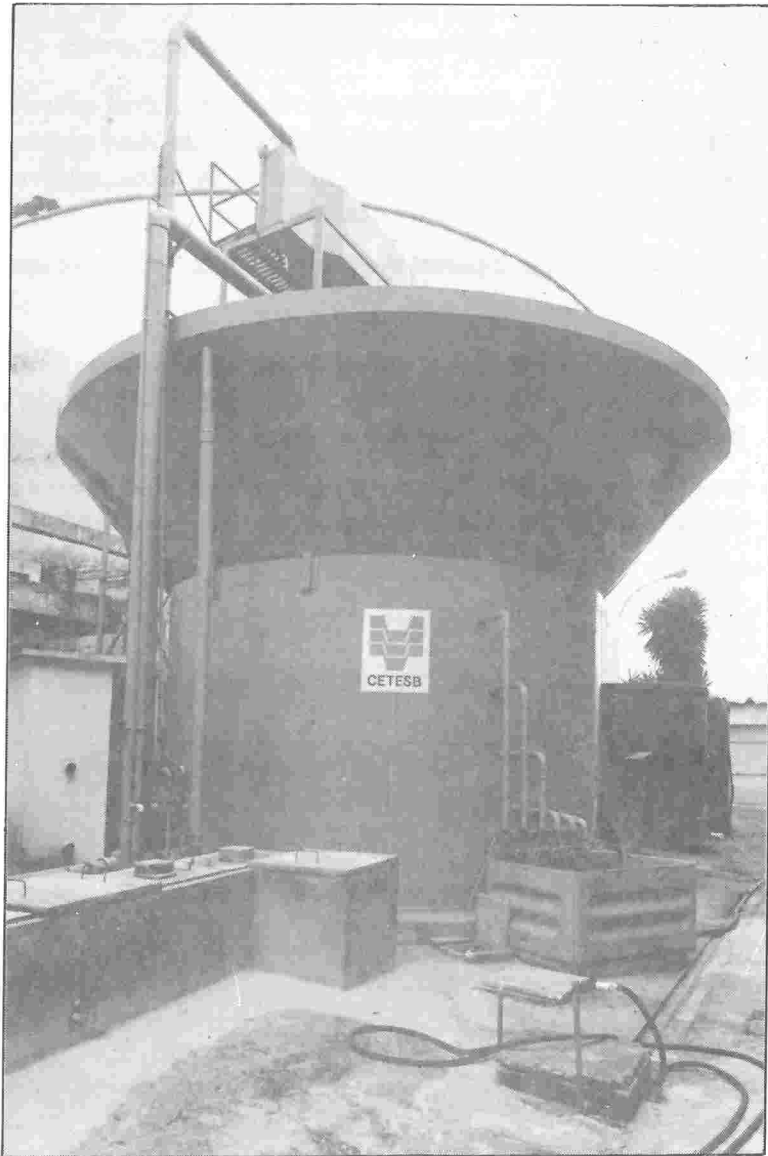
Reator anaeróbio de fluxo ascendente e manto de lodo.
