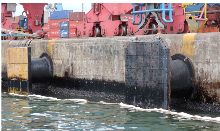
Figura 5.9 – Estrutura do cais impregnado com mancha de óleo
