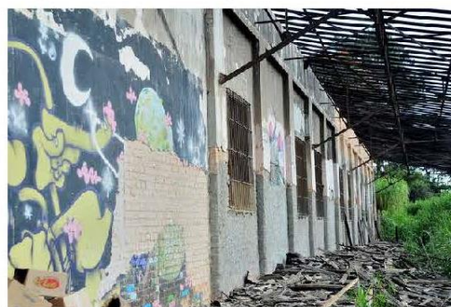
Situação de abandono gerou reclamações de vizinhos - EMÍDIO MARQUES
